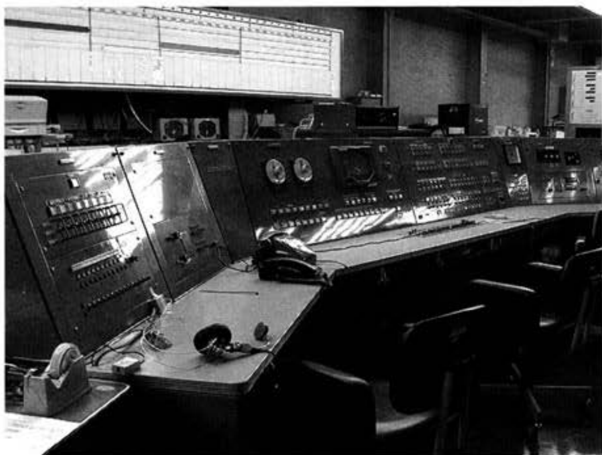
ロケットコントロールセンター。1970年代から何も変わっていない管制卓。正面の白いボードがタイムシークエンサーである。
