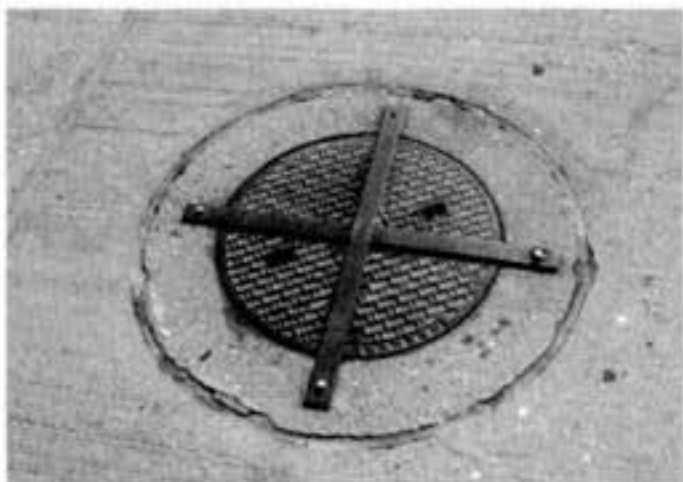
ボルト締めされたマンホールの蓋
